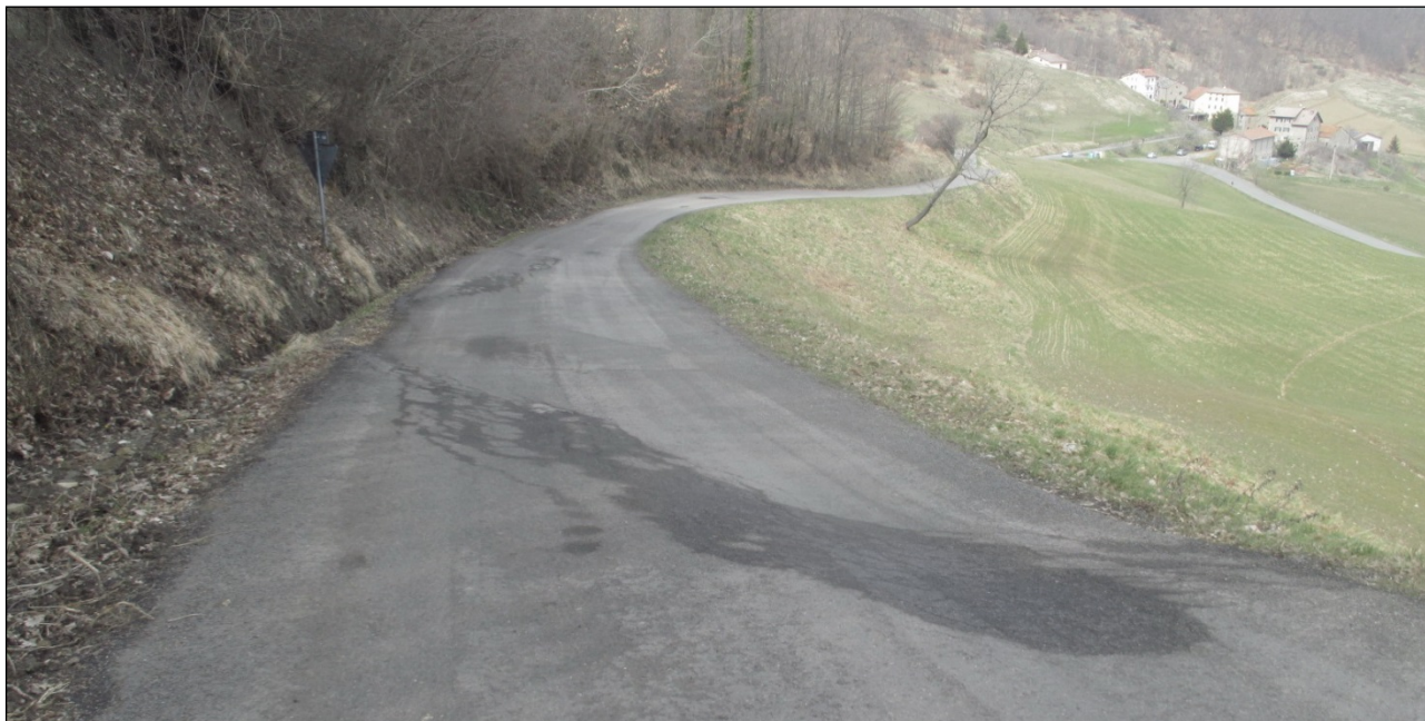
Figura 2: tratto interessato dai cedimenti decimetrici
